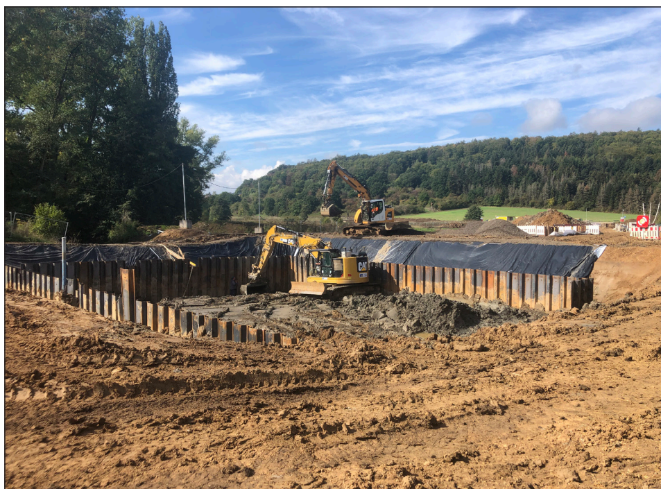
Abb. 10: Bau des Hochwasserrückhaltebeckens bei Treis (Foto: © Arbeitsgemeinschaft Heimatgeschichte Allendorf/Lumda, Aufnahme vom 29.9.2022, autorisiert)
